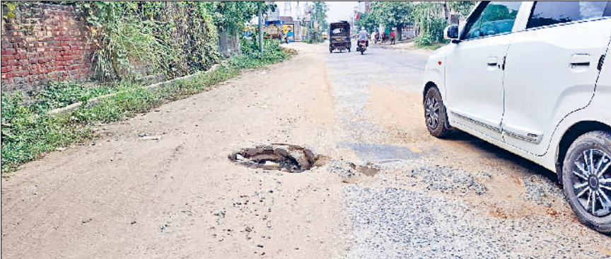
झज्जर। कच्चा बादली रोड पर सीवरज के मेनहॉल का टूटा हुआ ढक्कन व साइड से निकलते वाहन।
